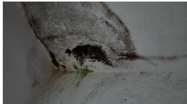
Schimmel in der Garage
